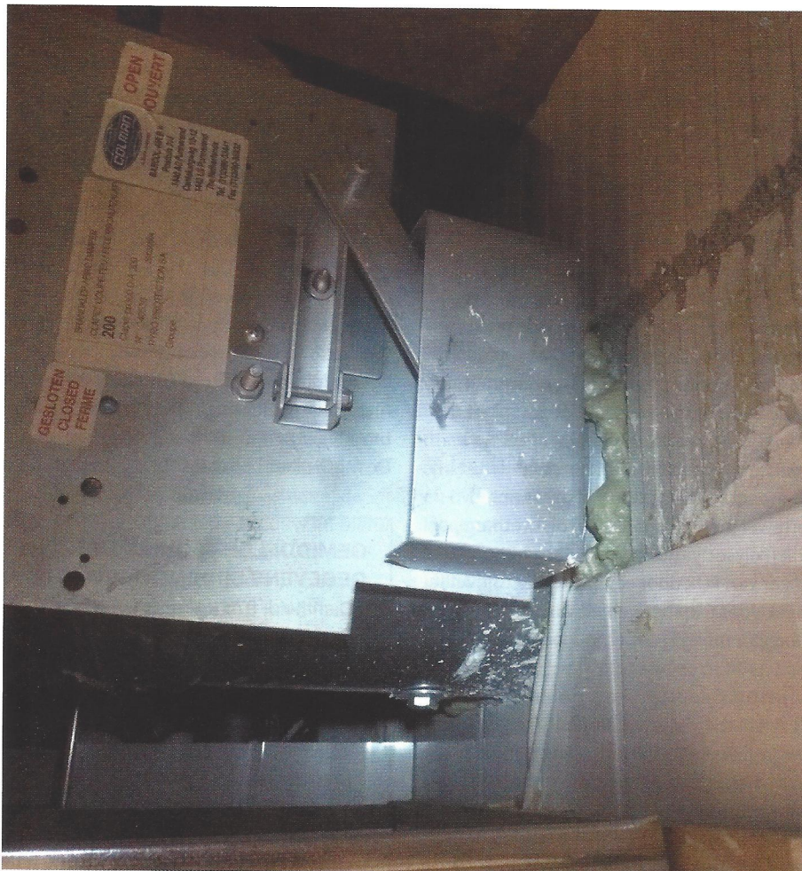
Een brandklep die niet goed is afgedicht en ook niet ver genoeg in de scheiding zit.
